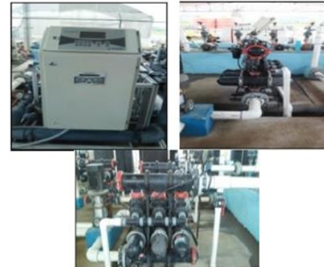
Figura 7. Sistema de riego automatizado.
